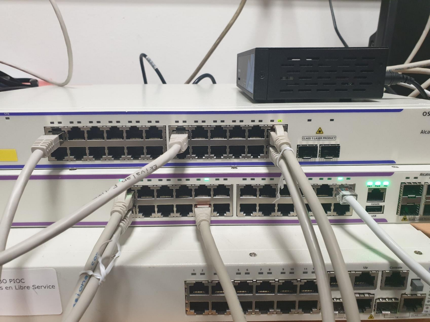
Switch1 et Switch2 (respectivement Switchs Alcatel OS6350-P24 et OS6450-P24) Annexe 6 :
